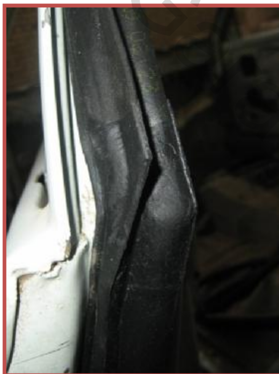
شكل 4- خارج از ريل بودن نوار دور درب در قسمت گوشه درب
